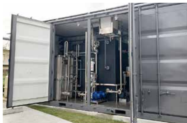
▶ 豊川本社に導入しているバイオトイレ
