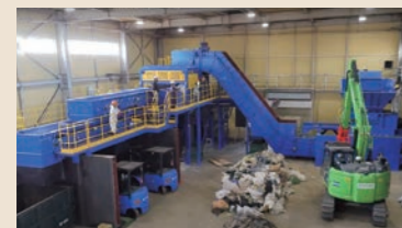
破碎ライン全景
