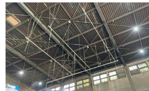
▶全プラントにスプリンクラーを設置
