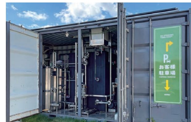
▶ 弊社が豊川本社に導入しているバイオトイレ
