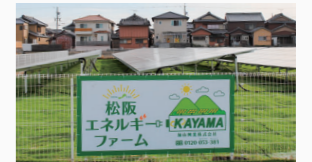
松阪エネルギーファーム (三重県松阪市)
