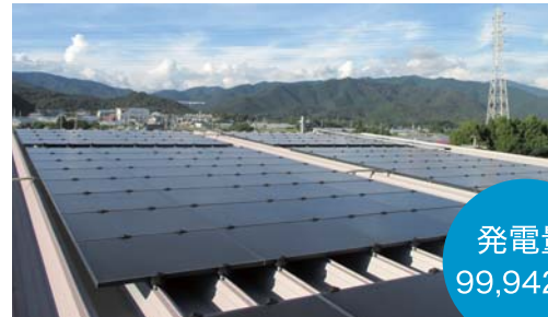
ストックヤード屋上に設置された太陽光発電パネル
